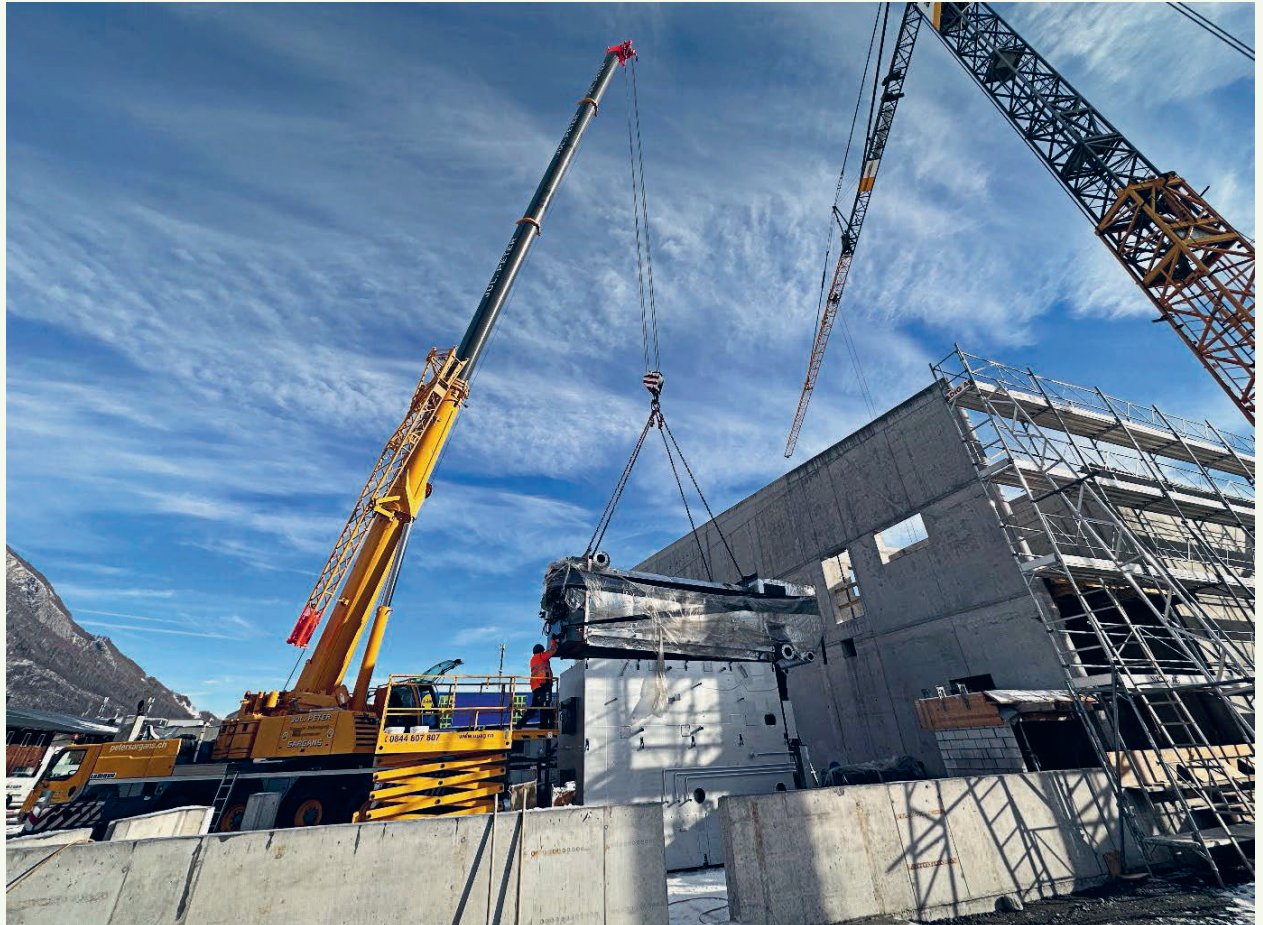
Der Holzschnittelkessel mit einer Leistung von ca. 2,5 MW liefert den Grossteil der Heizenergie.
